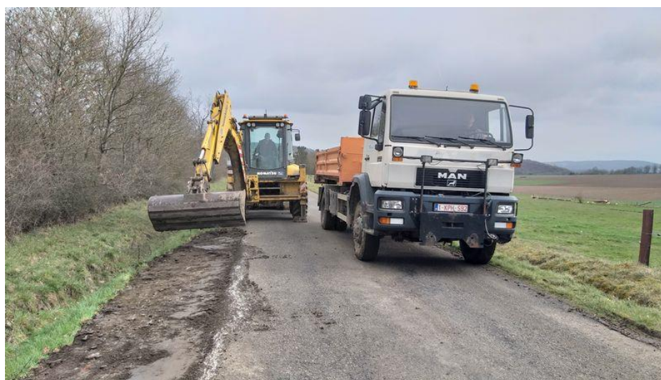
Arasement de la rue de Vaucelles à MAZÉE
