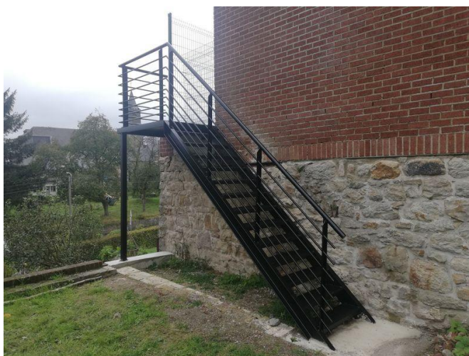
Réparation et aménagement de l'escalier de secours et de la clôture à l'école de OIGNIES
