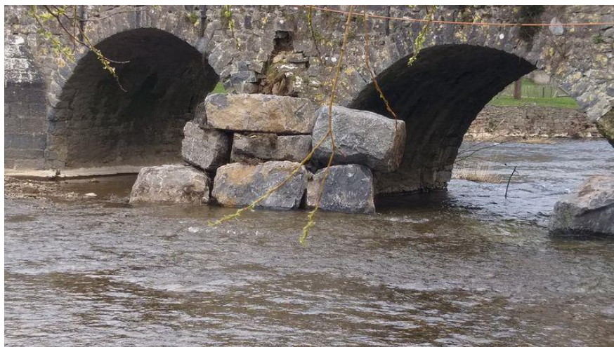
Mise en place d'enrochements pour sécuriser le pont rue Basse aux Raines à TREIGNES
