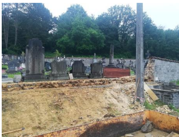
Réparation d'une partie du mur de l'enceinte de l'ancien cimetière de MAZEE
