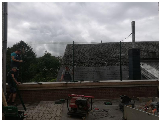
Réparation et aménagement de l'escalier de secours et de la clôture à l'école de OIGNIES
