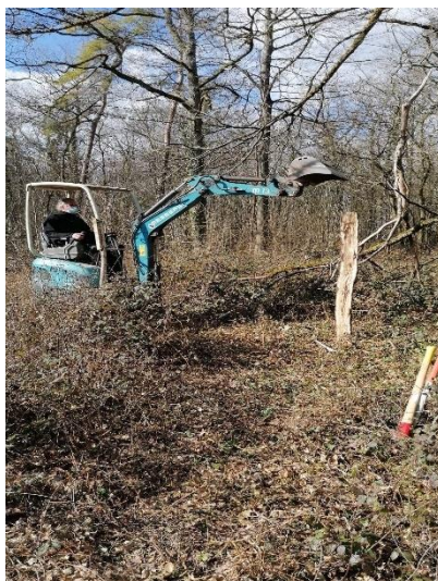
Pose d'une clôture dans le bois DOORBES/OLLOY à la demande du DNF
