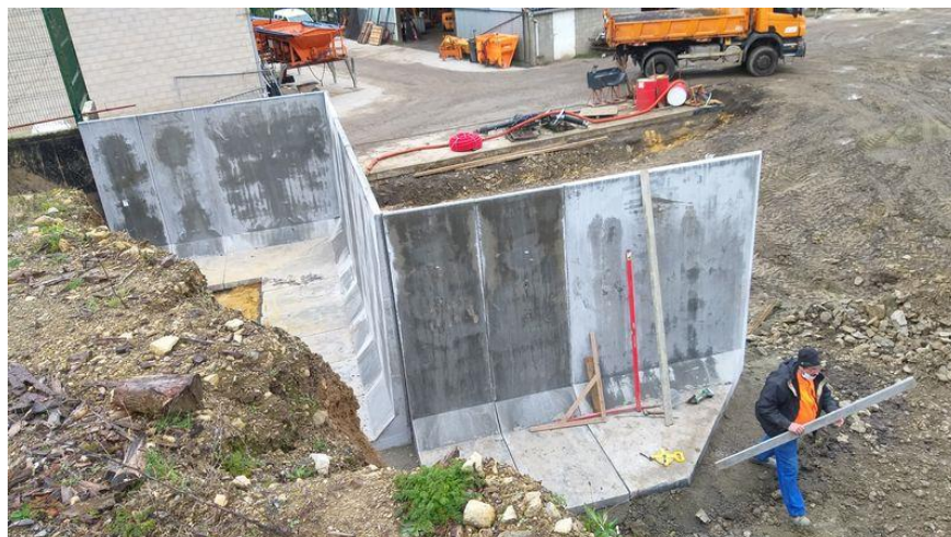
Placement de « L » en béton au hall technique en vue d'accueillir les containers du BEP destinés aux déchets communaux
