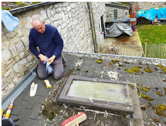
Réparation d'un velux à la salle de la balle pelotte à VIERVES
