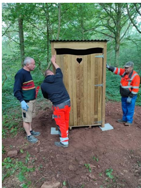
Placement des toilettes sèches dans les bivouacs de MAZÉE et NISMES
