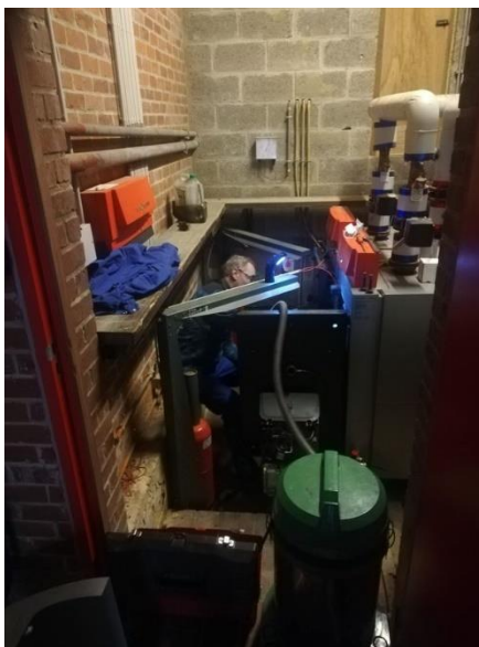
Entretien des chaudières
