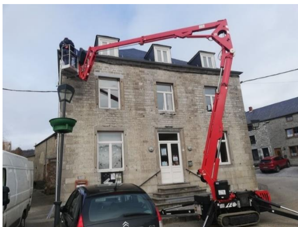
Mise en place d'une guirlande de Noël à la Maison de village de DOORBES
