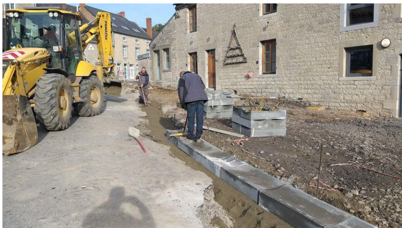
Renouvellement des abords de la « Ferme Jardin » au niveau du Centre Culturel de NISMES
